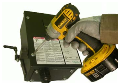
Figura 16: Extracción de los tornillos de la cubierta para abrir el gabinete (PBPQOD, PBPQHD)
