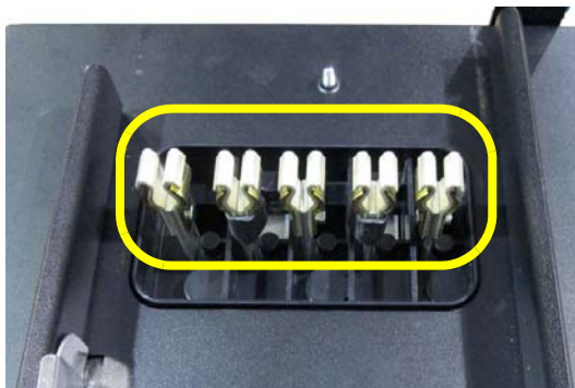
Figure 6 : Inspection des mâchoires d'enfichage
