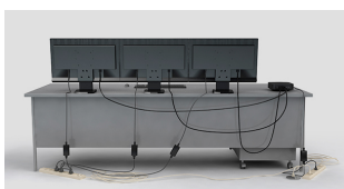
Herkömmliche Lösung: unordentliche Verkabelung
