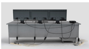
Collegamento tradizionale: cablaggio disorganizzato
