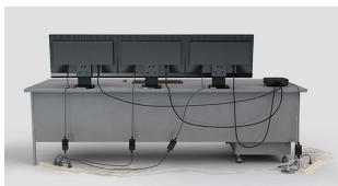
Gangbare oplossing: rommelige bekabeling
