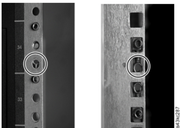
Figura 36. Ubicaciones de conector incorrectas
